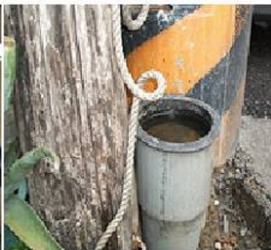
台電地下電纜引上管
