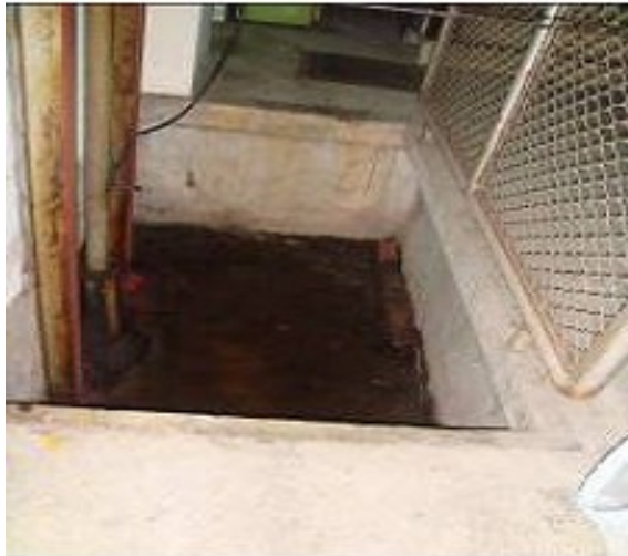
地下室之升降梯孔積水
