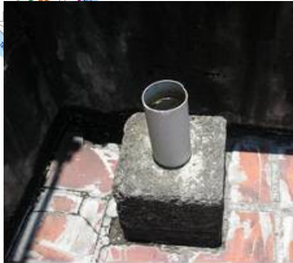
水泥樁上之水管
