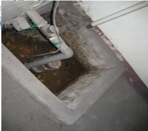
地下室儲水槽
